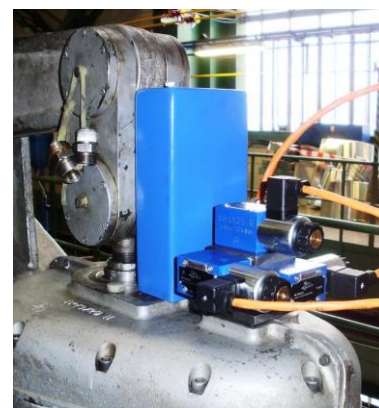
Ovládání uzavíracího ventilu PSK a snímač polohy
