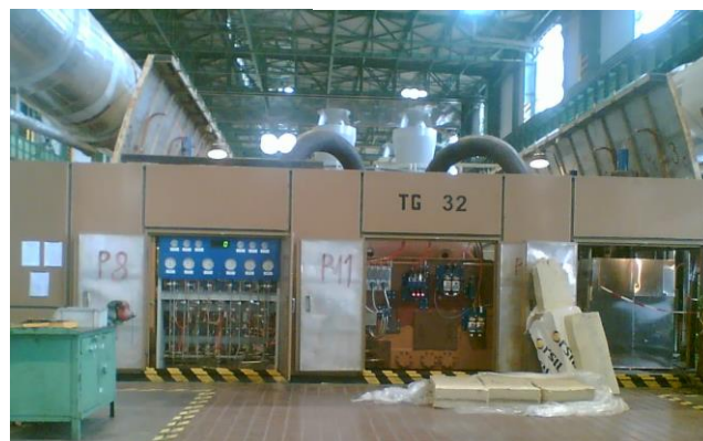
Pohled na čelo turbíny
