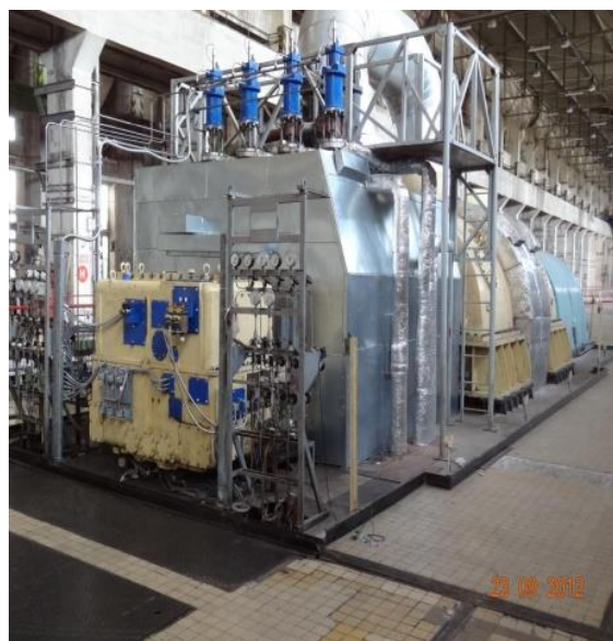
Turbína 60 MW po modernizaci – celkový pohled
