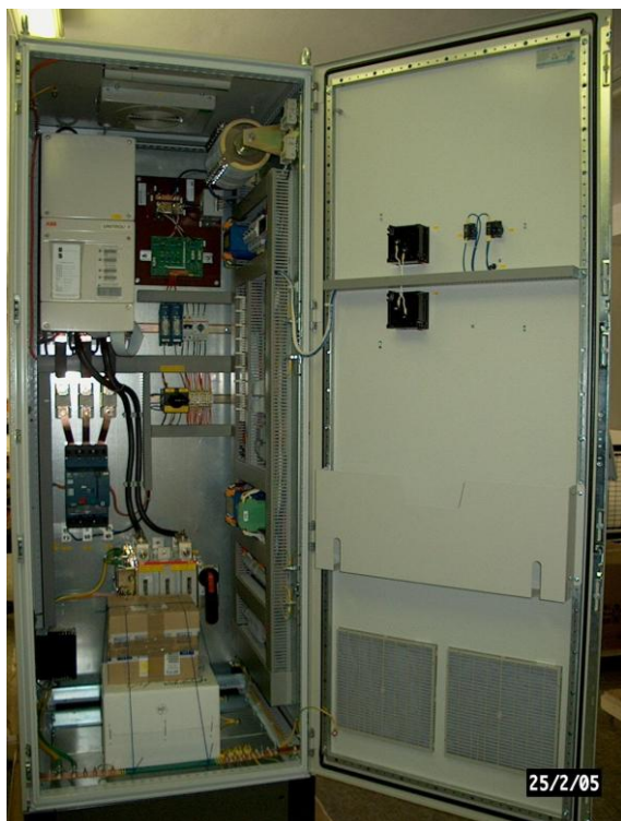
Pohled na jeden ze tří rozváděčů
