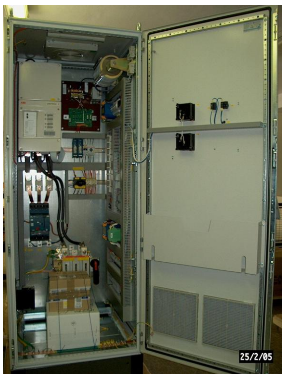
Pohled na jeden ze tří rozváděčů
